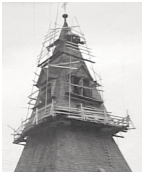
In den 1950er Jahren gab es eine Sanierung der Kirchturmuhre, des Wetterhahnes und der Dachhaut. Alfred Weis hat dies in Film und Bild festgehalten.
